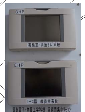
電気・ガス空調集中管理盤
