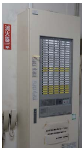
火災報知器受信盤
