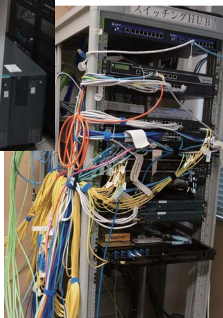
LAN 管理室配線HUB
