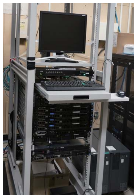
LAN 管理室サーバ
