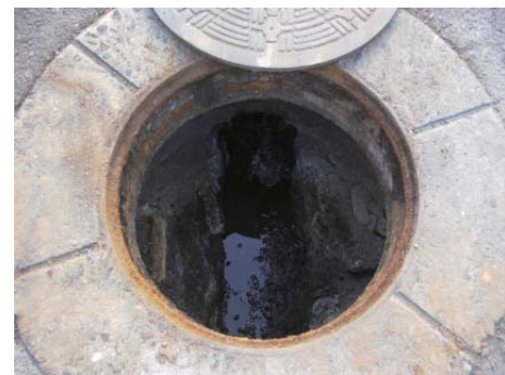
排水枡内部状況 インバート部が老朽化している
