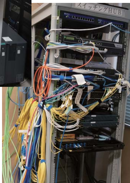
LAN 管理室配線HUB
