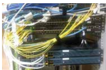
センタースイッチ等 Center Switch for Campus LAN
