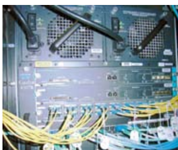
センタースイッチ Center Switch for Campus LAN
