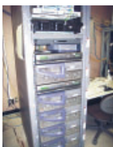
ネットワークシステム サーバ Server Workstations for Campus LAN
